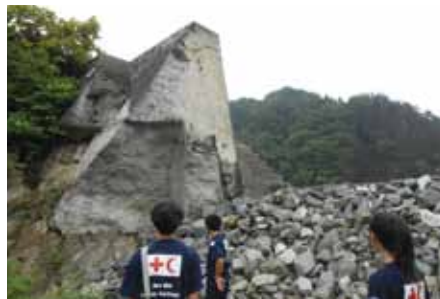
壊れた防波堤は12m
