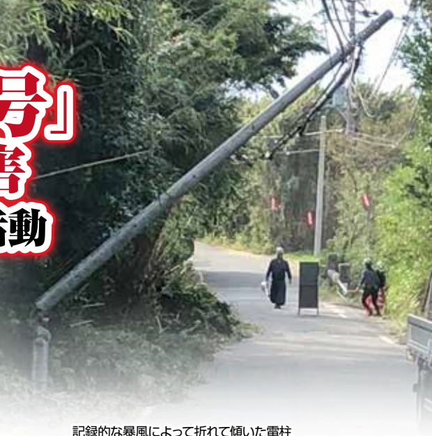
記録的な暴風によって折れて傾いた電柱
