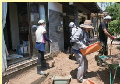
被災した家屋の片付け
